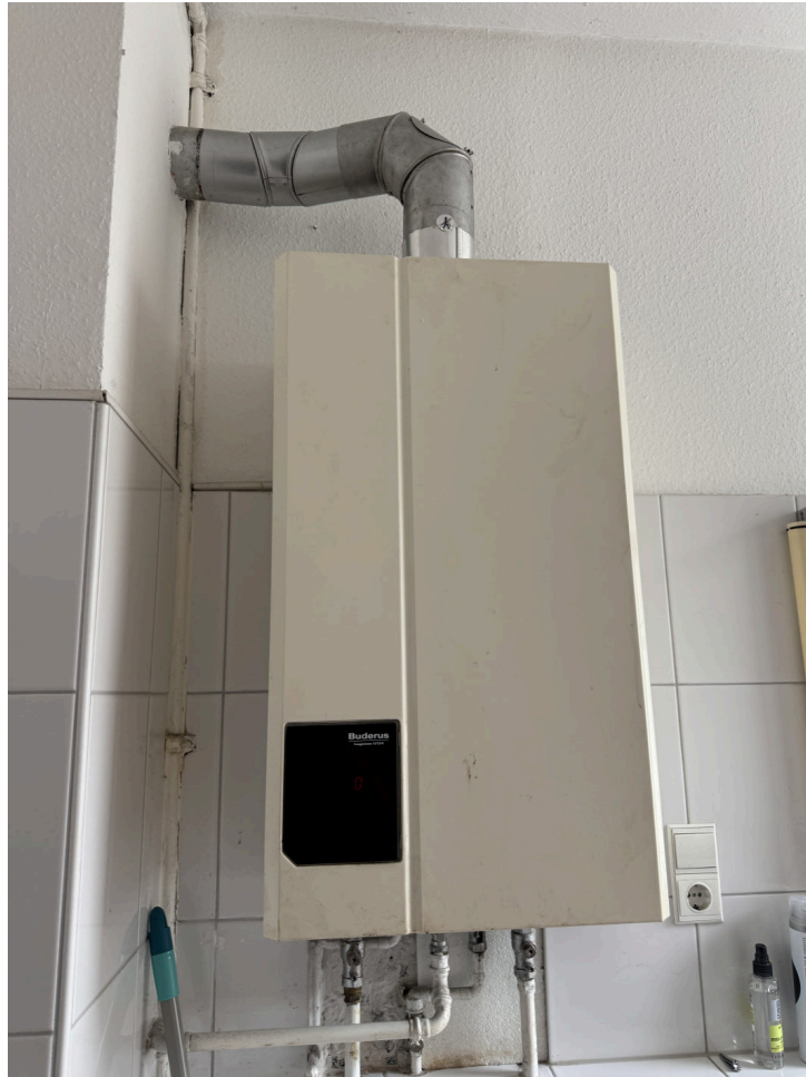
Beispiel einer älteren Etagenheizung (Alter rund 15 bis 20 Jahre), planbare Austauschmaßnahme im Erwerbszeitraum. Erstellt am 16.06.2026 um 16:31 Uhr.
