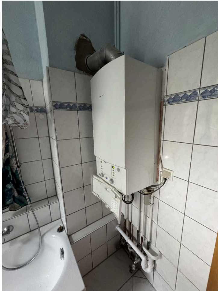
Beispiel Etagenheizung in einer Wohnung im straßenseitigen Gebäudeteil, wandhängende Gas-Therme.
