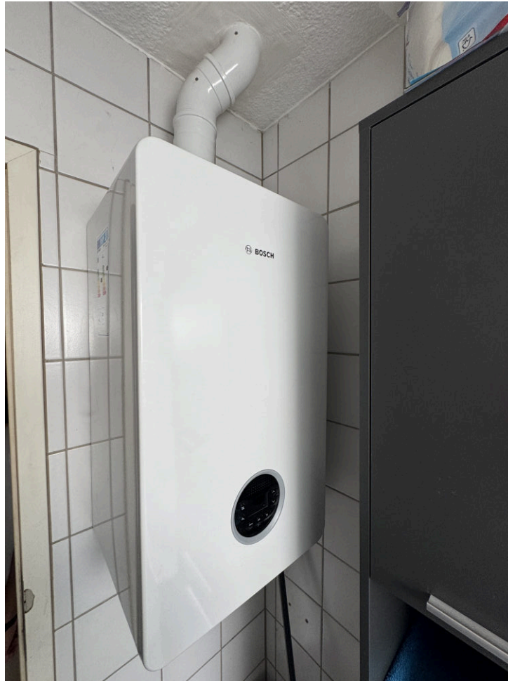
Beispiel einer neuwertigen Etagenheizung in einer Wohnung im Dachgeschoss des rückwärtigen Gebäudeteils. Erstellt am 16.06.2026 um 16:51 Uhr.
