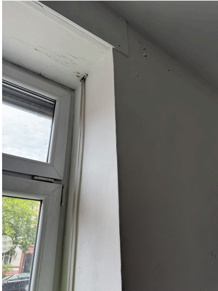
Beispiel Innenoberfläche in einer Wohnung, örtliche Farbabplatzungen, übliche Renovierungsmaßnahme. Erstellt am 16.06.2026 um 15:53 Uhr.
